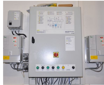
Umweltkontrolle: Schaltkasten für die Nais-Wasseraufbereitungsanlage.
